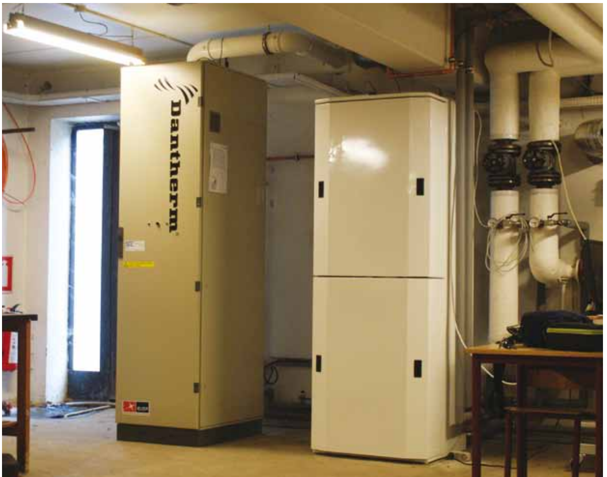
Et af de første anlæg i Varde med brændselscelleunit til venstre og varmelager til højre. Varmelageret er blandt andet nødvendigt på disse anlæg i perioder med relativt lille varmeforbrug.
