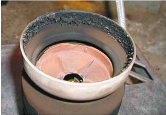
Tilsødet brænderhoved. Dårlig forbrænding på grund af lav O 2 .
