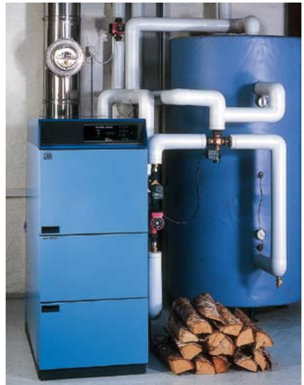
installation med brændekedel og varmelagertank. Foto: Baxi.
