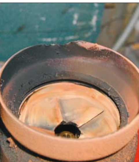
Defekt ikke rensset brænderhoved.
