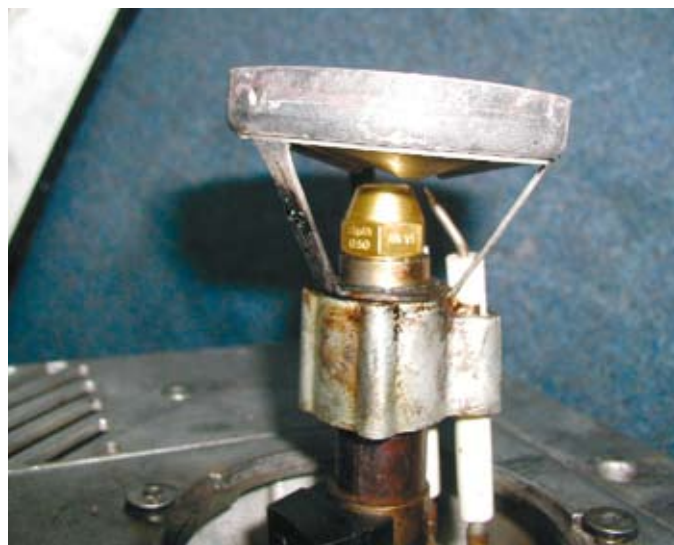
Skæv luftfordeler giver meget sod i forbrændingen.
