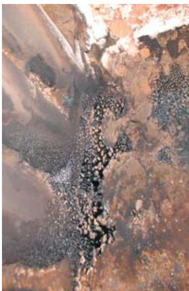
Dårlig forbrænding med glanssod.
