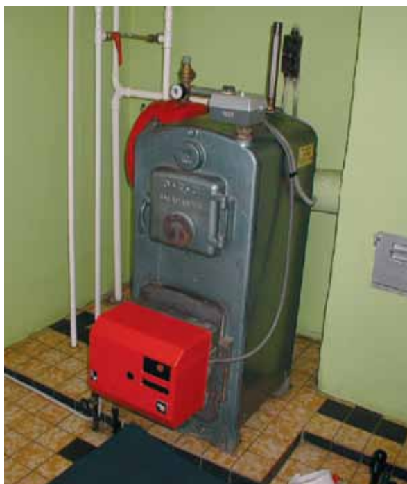
Energistyrelsen kan foreskrive et energisyn på kedelanlægget, når kedlen som denne typiske støbejernskedel er fra før 1977.
